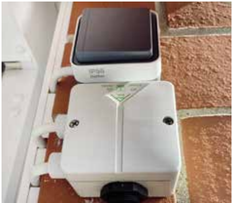
Ordnungsgemäß: Ein Wielandstecker verbindet die Anlage mit dem Stromnetz und ...
